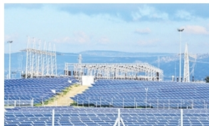
Distesa di pannelli in un impianto fotovoltaico
